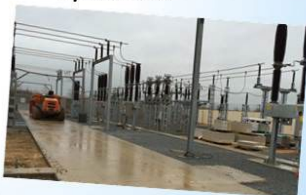
Poste 90/20kV Grande Haye (35)
